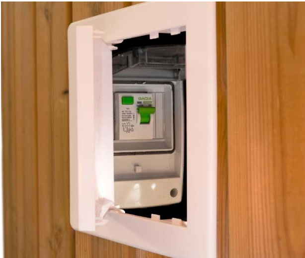
Kuva 23: FI-suojakytkimen sijainti ja kuva (päällä)
